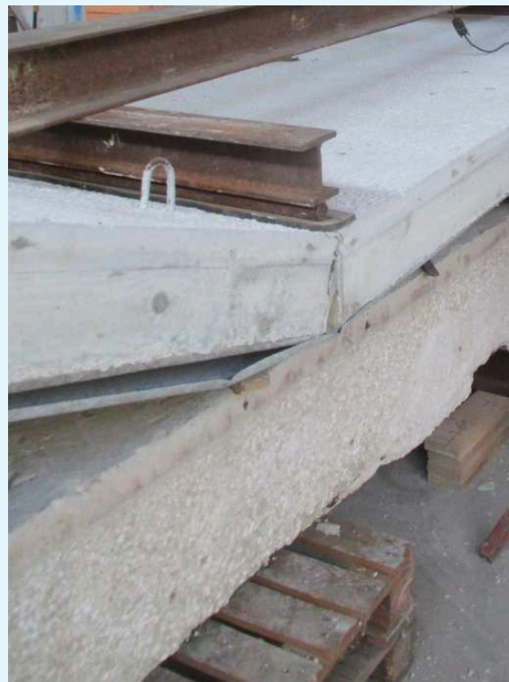
Fotografia del particolare del distacco di lamiera del campione dopo il collasso.
